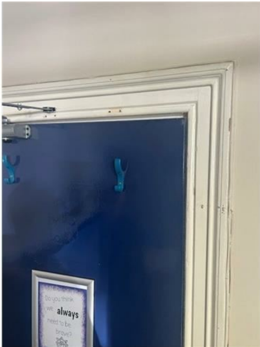
Hazel Main excessive door gap.jpg
